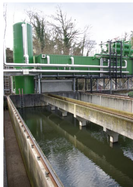
Wärmepumpencontainer in der ARA Rheinfelden
