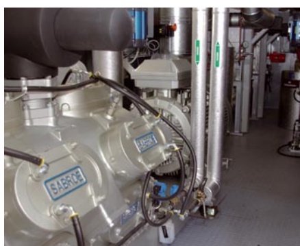
Einer der beiden Kompressoren im Wärmepumpencontainer
