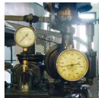
Turbinenregler zur Regelung des Wasserzuflusses auf die Turbine.
