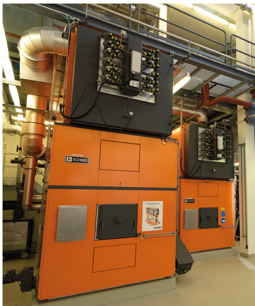
Der Heizraum in der Wärmezentrale Isenlauf
